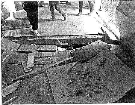
写真2 受付付近にできた段差
